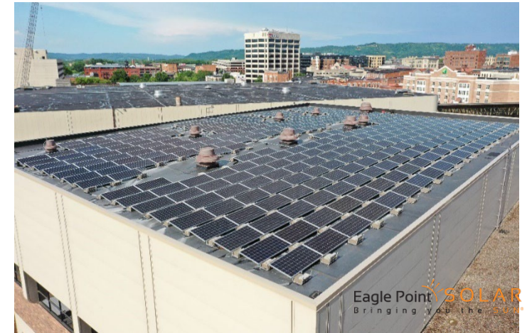
La Crosse Center: 100 kW
