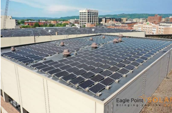
La Crosse Center: 100 kW
