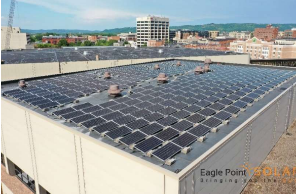
La Crosse Center: 100 kW
